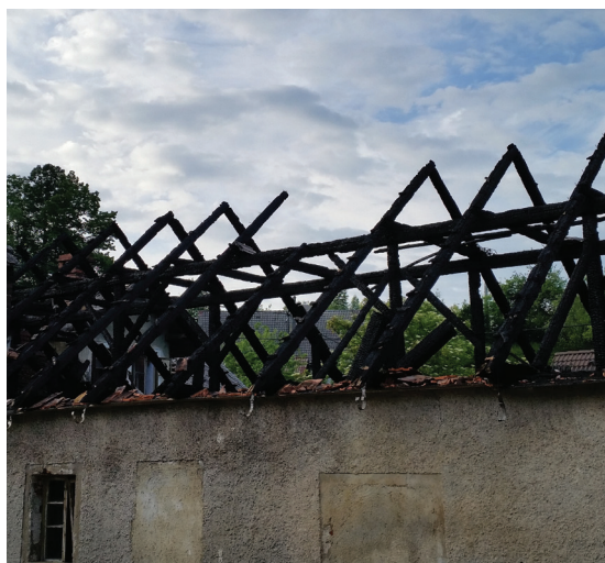
Slika 3: Posledice dimniškega požara – prenos požara na stavbo
