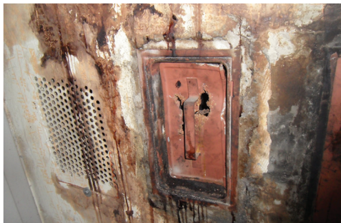
Slika 4: Poškodbe dimovodnih naprav
