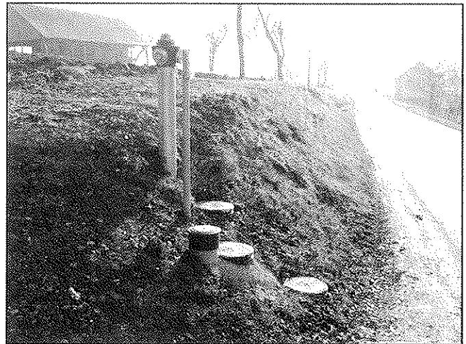
Vodovodni hidrant na omrežju
